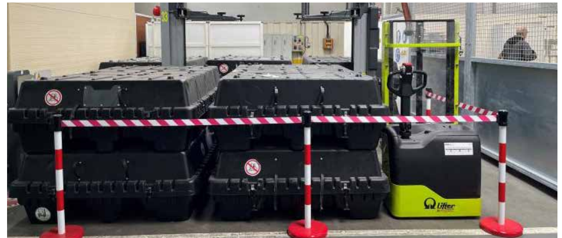
Batteries stockées au sol
